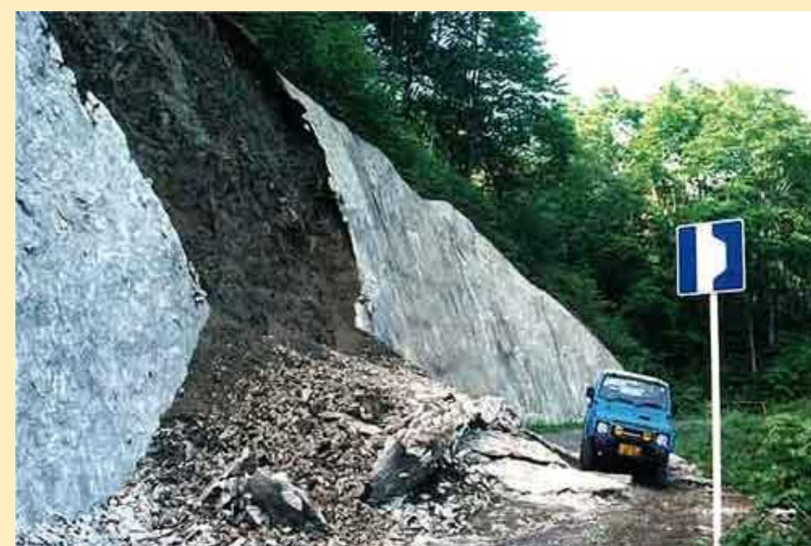
吹付けコンクリートのり面崩壊の事例
